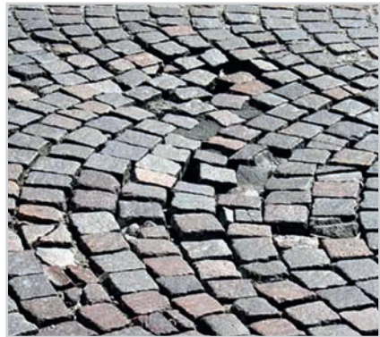
Abbildung 6: Fehlerhafter Pflasterverbund infolge von Absenkungen
